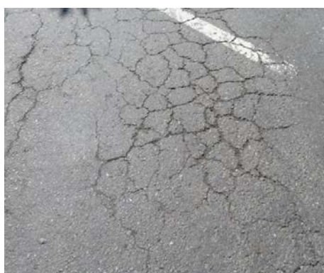
圖 5 原路段龜裂近照
