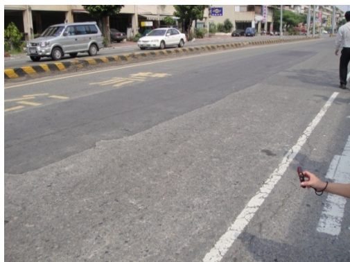
(a) 管線開挖修補及鋪面老化
