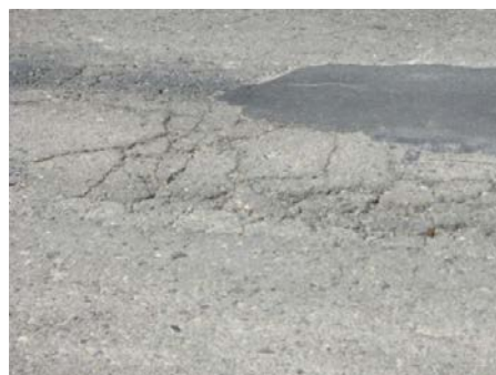
(b) 鋪面產生嚴重龜裂
