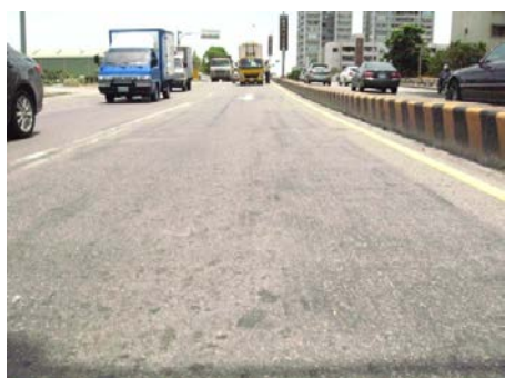
(a) 內車道車轍變形嚴重
