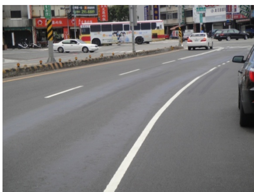
(a) 外車道車轍處冒油
