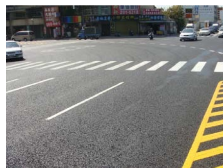
(a) 路面整齊平順，局部油斑現象
