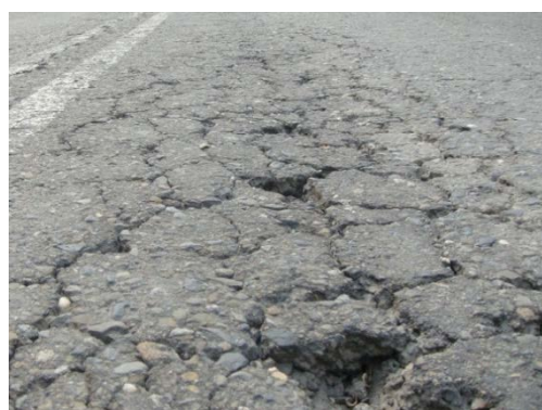
(b) 鋪面龜裂產生坑洞
