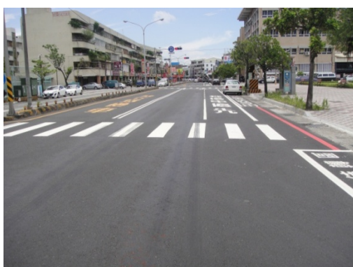
(a) 外車道車轍處冒油
