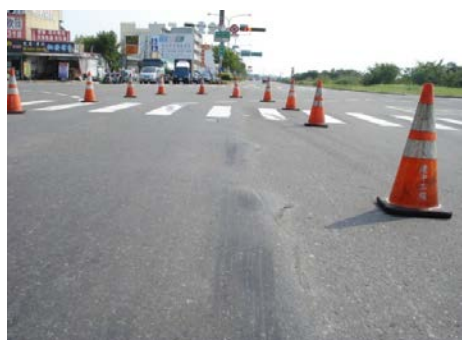
(a) 鋪面產生嚴重側擠
