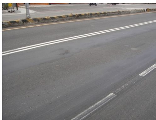
(b) 外車道鋪面產生坑洞
