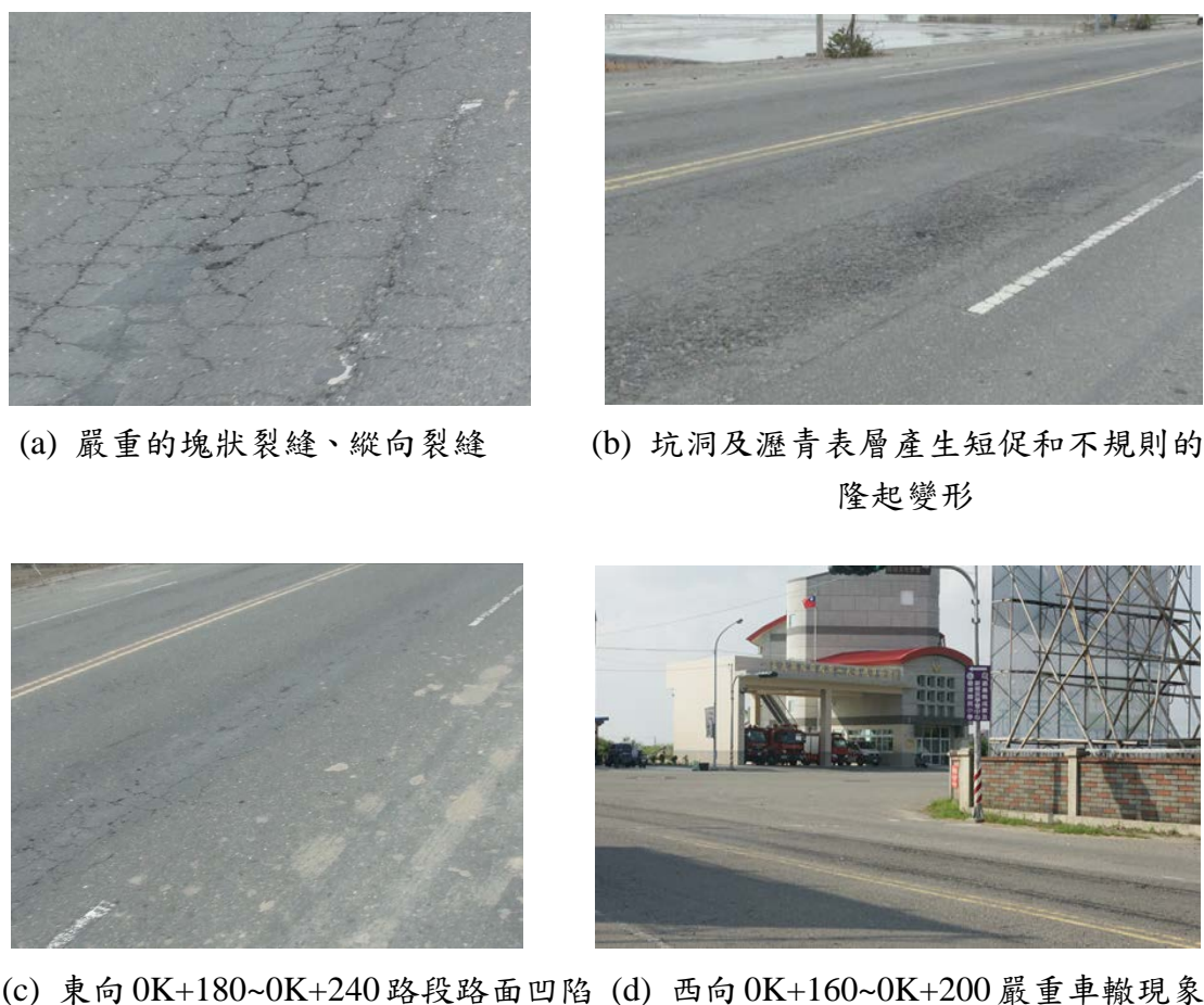
圖 6 施工前路面破壞情形
