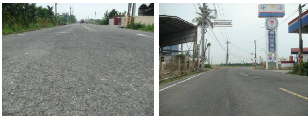
(a) 路面破壞及與鄰近建物
