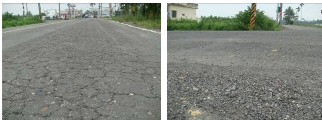
(a) 鱷魚狀龜裂破壞
