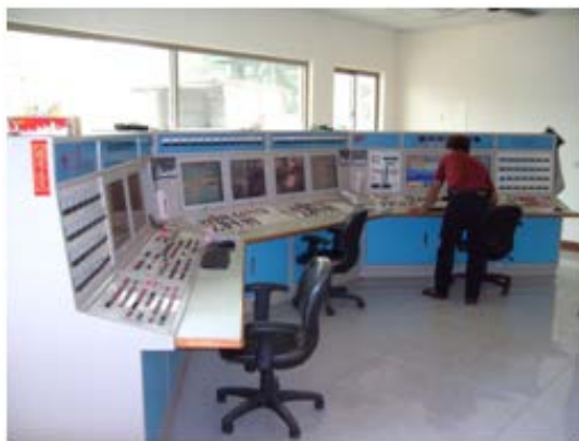
圖 17 控制室(全電腦化自動)
