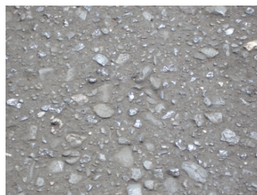
圖 33 瀝青包裹不全粒料磨損
