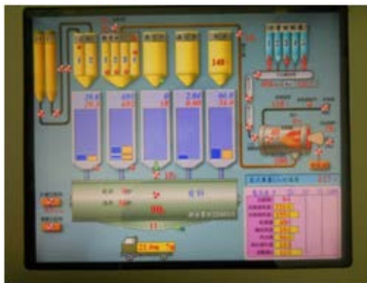
圖 18 控制室(供應系統介面)
