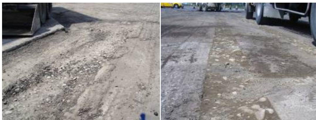
(a)水溝施工回填壓實不足
