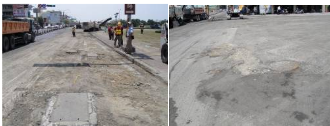
(a) 弱電寬頻管線開挖痕跡
