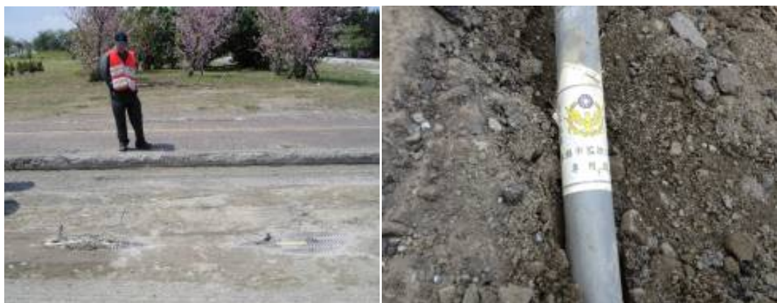
(a)管線保護層破損
