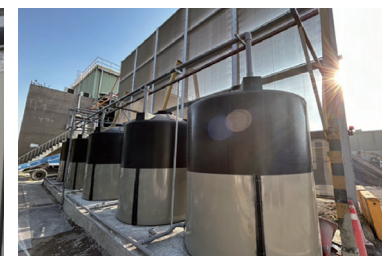
利昌工場新增雨水回收設施
