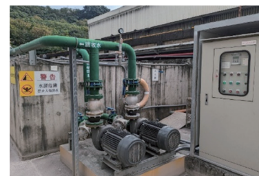
沿海廠廢(污)水(前)處理設施 新增回收水系統
