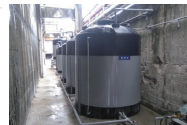
南部研磨廠 B 工場原料儲倉屋頂 收集雨水再利用
